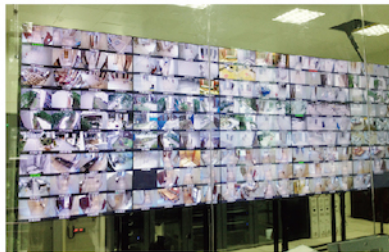
遵义宾馆机房电视墙
